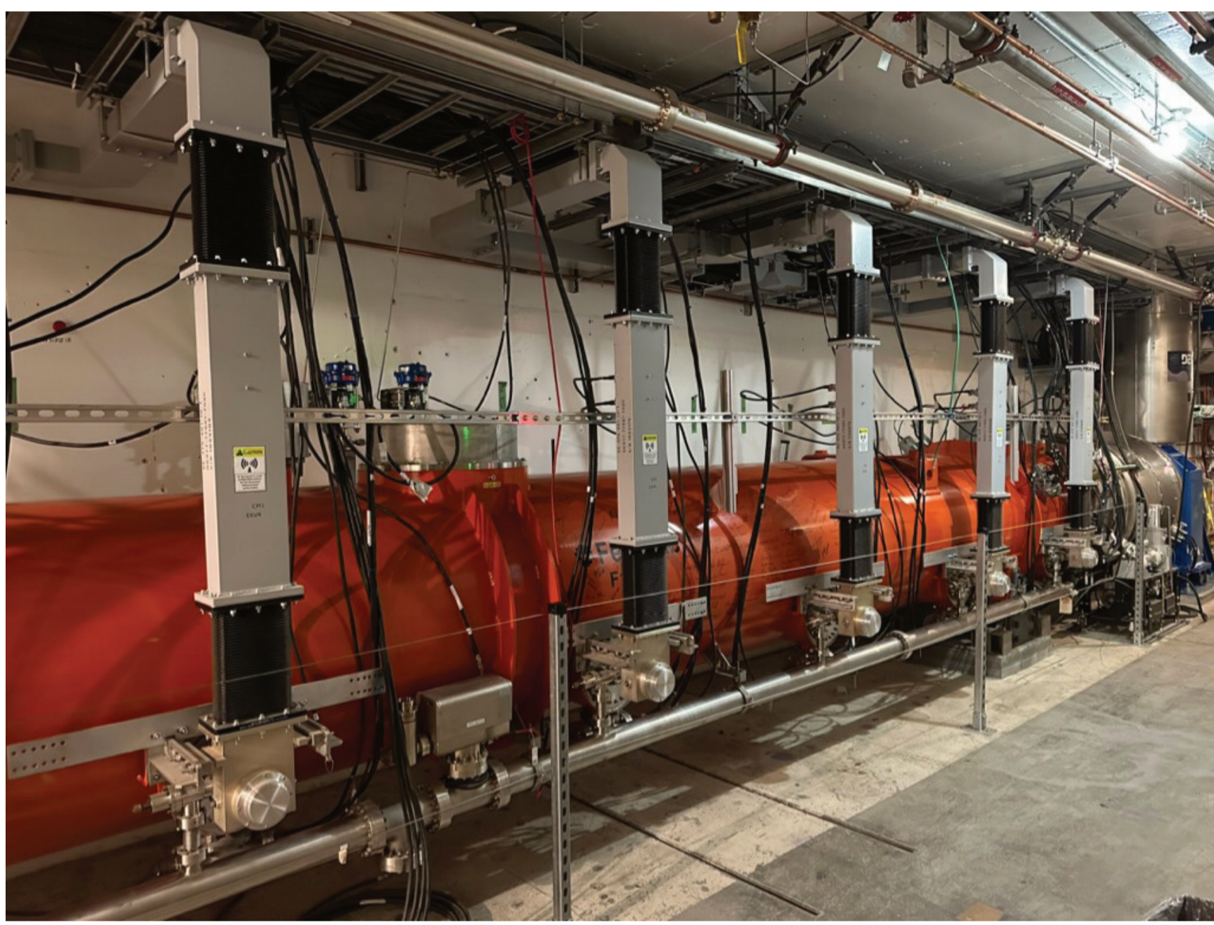
LCLS-II cryomodule string
